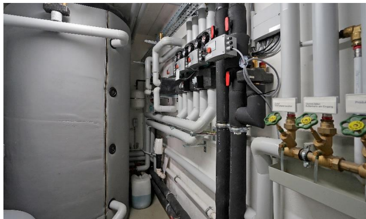
MHC GmbH, Heizungskeller/©Rechenbach
